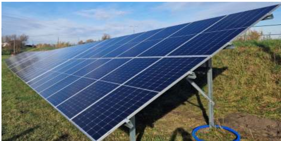
Instalacja fotowoltaiczna na terenie oczyszczalni ścieków
