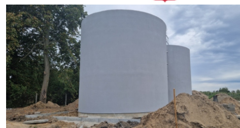
Żelbetonowe zbiorniki wyrównawcze wody czystej
