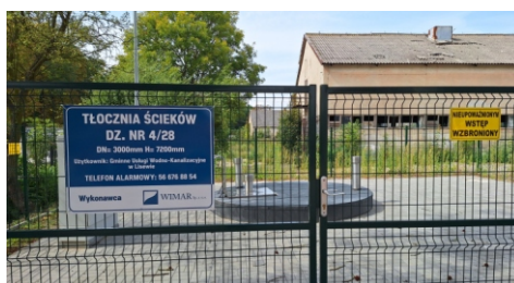
Tłocznia ścieków w Lipienku
