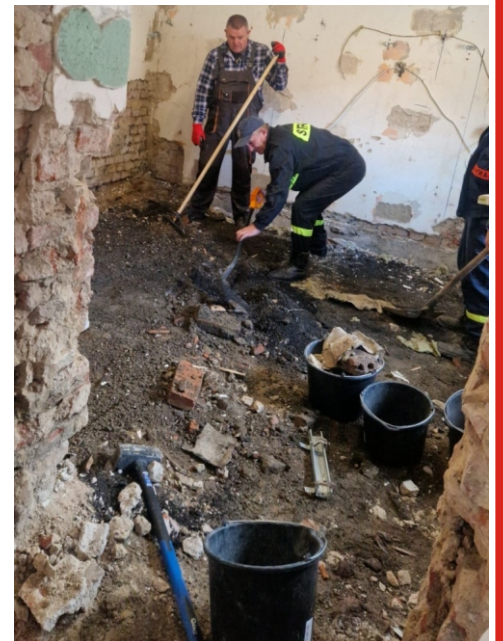
Strażacy udzielali pomocy m.in. w porządkowaniu budynków mieszkalnych
